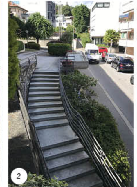
2 Demolizione della scala di accesso, della fontana e delle bordure fiorite e costruzione del nuovo muro
