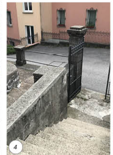
4 Demolizione della scala di accesso lato sud e rimozione del percorso lungo il muro con conseguente modellazione del terreno
